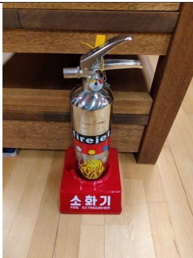
庫房內之消防設施
