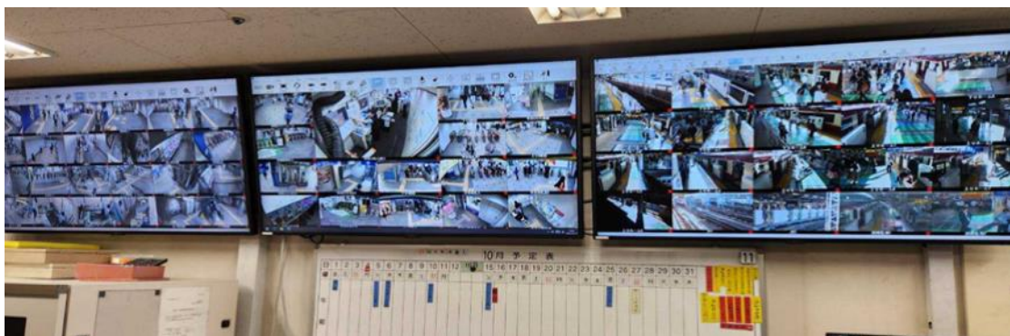
圖 58 高效能監視設備
