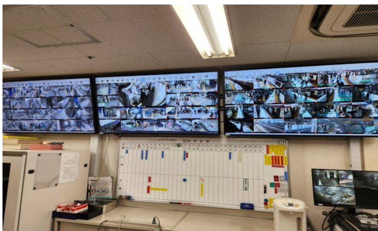
圖 23 橫濱站全站監視設備影像
