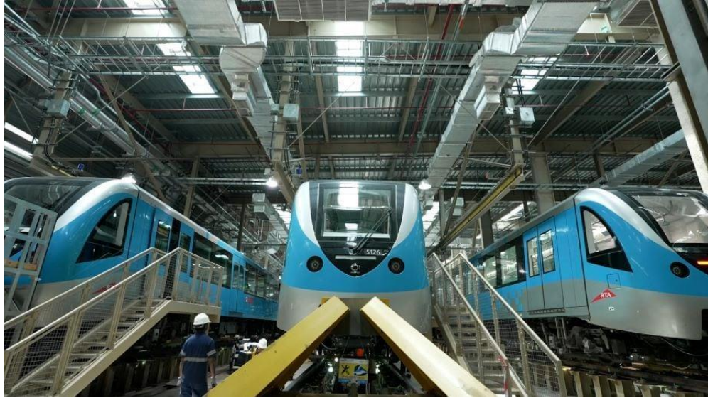
圖 40 杜拜 Rashidiya 捷運場站內部車廂維修保養
