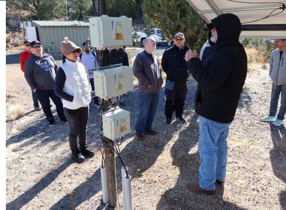
聖喬治太陽能泵系統－太陽能供電設備及控制設備
