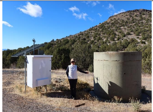
聖喬治太陽能泵系統－抽水井及控制設備
