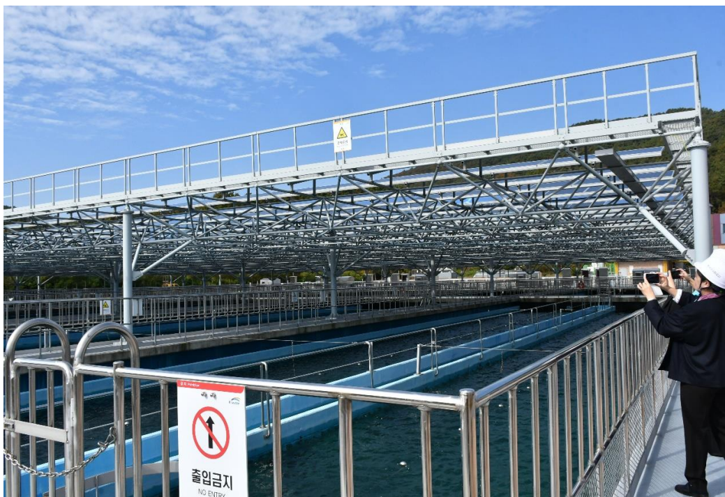
圖 74 華松 AI 淨水場之沉澱池上方設置太陽能板
