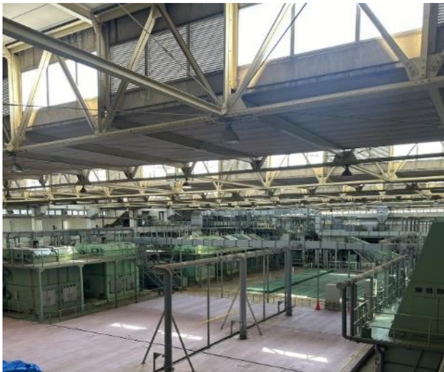
圖 42 荒川水再生中心前處理設施
