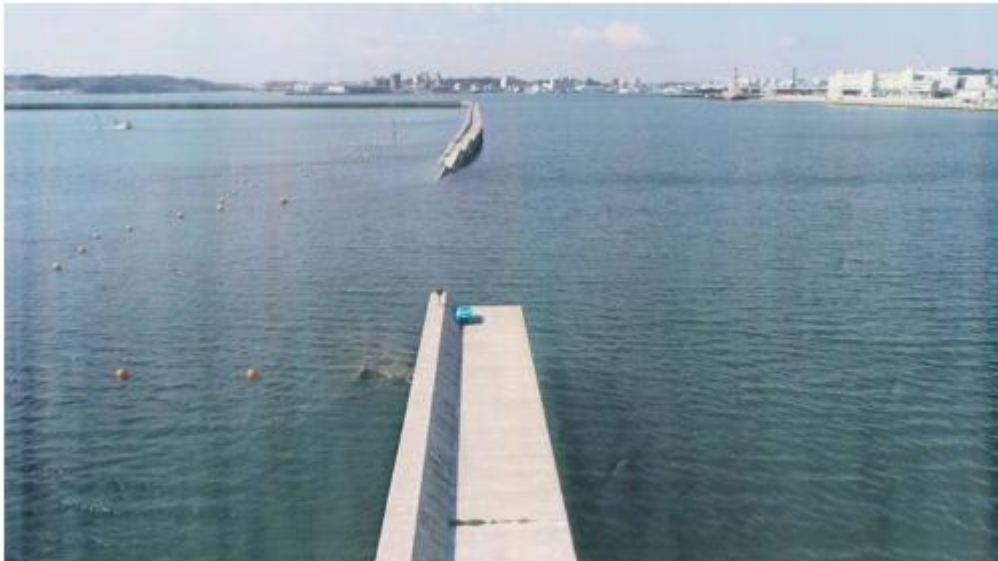
宮城県塩釜漁港の防波堤が約120mわたって倒壊。うち約60mが水没した（写真：宮城県） [画像のクリックで拡大表示]
