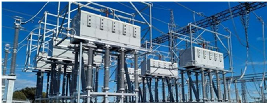
圖 43 澳洲 Transgrid 使用 APFC 來解決兩個州之間輸電線路上的熱容量限制問題[24]
