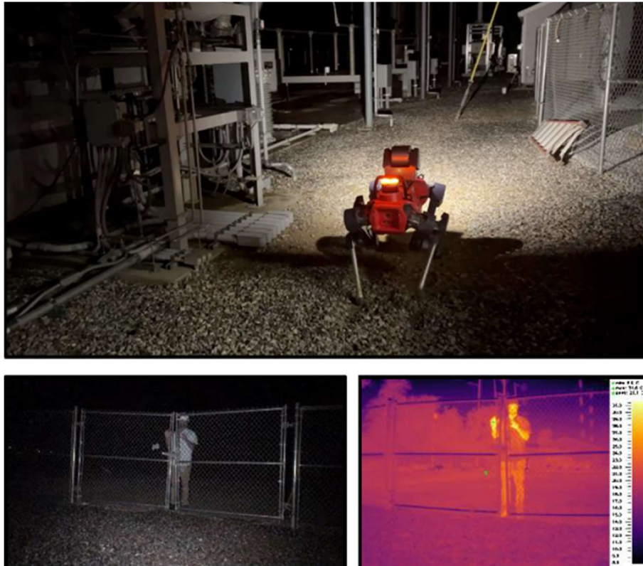
圖 51 EPRI 研究並評估 ANYmal 執行巡邏變電所周邊的能力[17]
