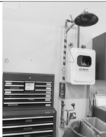
緊急化學污染淋浴設備
