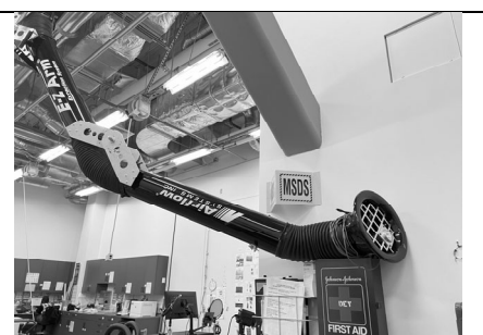
電源插座採天花板垂懸式，懸臂抽風器從連結天花風管排風。
