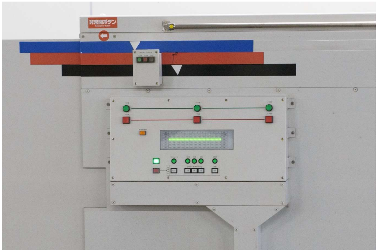
圖 36 所澤站月台門控制設備
