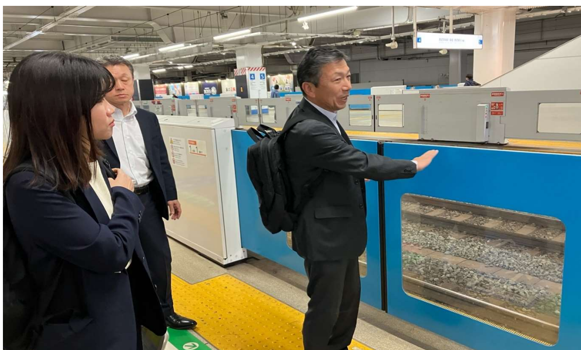
圖 35 西武鐵道公司安全推進部部長介紹所澤站月台門設備
