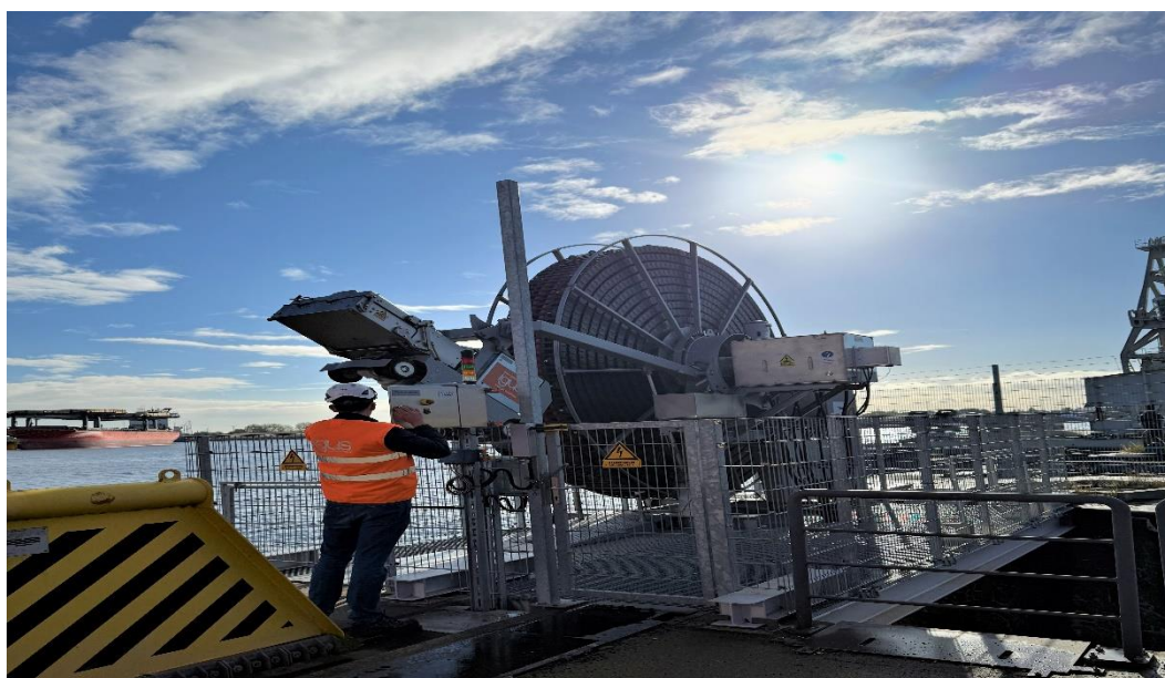
【圖 16、設置於 CTT 碼頭邊角的電纜鏈捲盤型式岸電系統】
