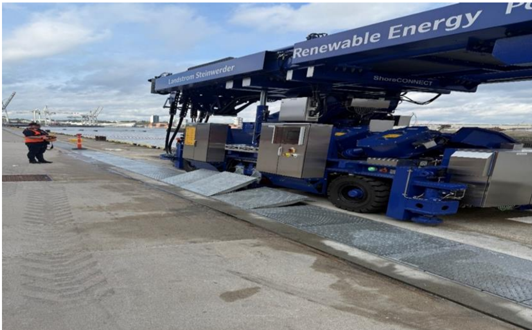
【圖 9、Steinwerder 郵輪碼頭移動式電纜車，電纜埋藏於鐵蓋下方】
