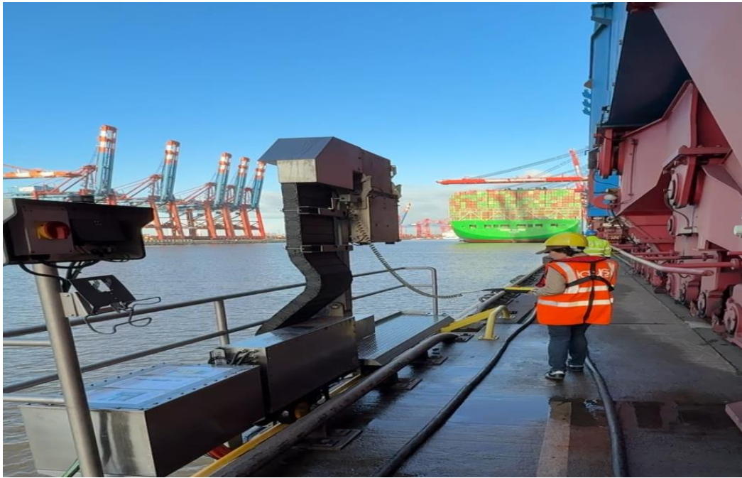
【圖 14、本公司蔡淑慧資深處長現場操作移動式岸電設施】
