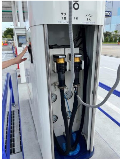
圖 3-34、防止車輛誤啟動措施 (加氫槍脫離裝置)
