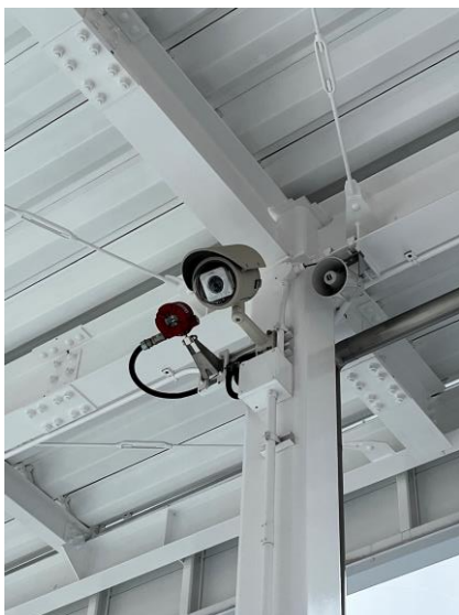
圖 3-32、加氫機周圍火災檢知措施 (火焰檢知器)
