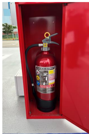
圖 3-36、滅火設備(乾粉滅火器)
