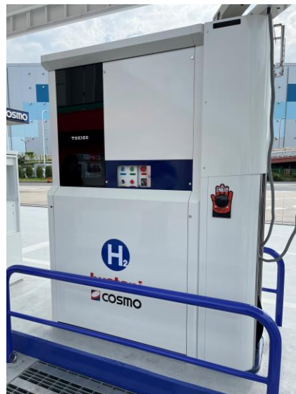
圖 3-33、氣體設備防止車輛碰撞措施 (防護欄)
