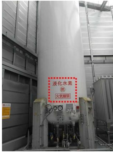
圖 3-17、儲槽標示措施
