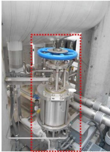
圖 3-22、儲槽配管的緊急遮斷裝置
