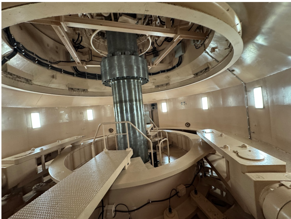
圖 16：水輪發電機軸承
