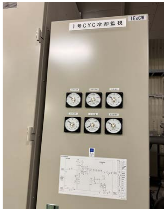
圖 18：冷卻監視設備
