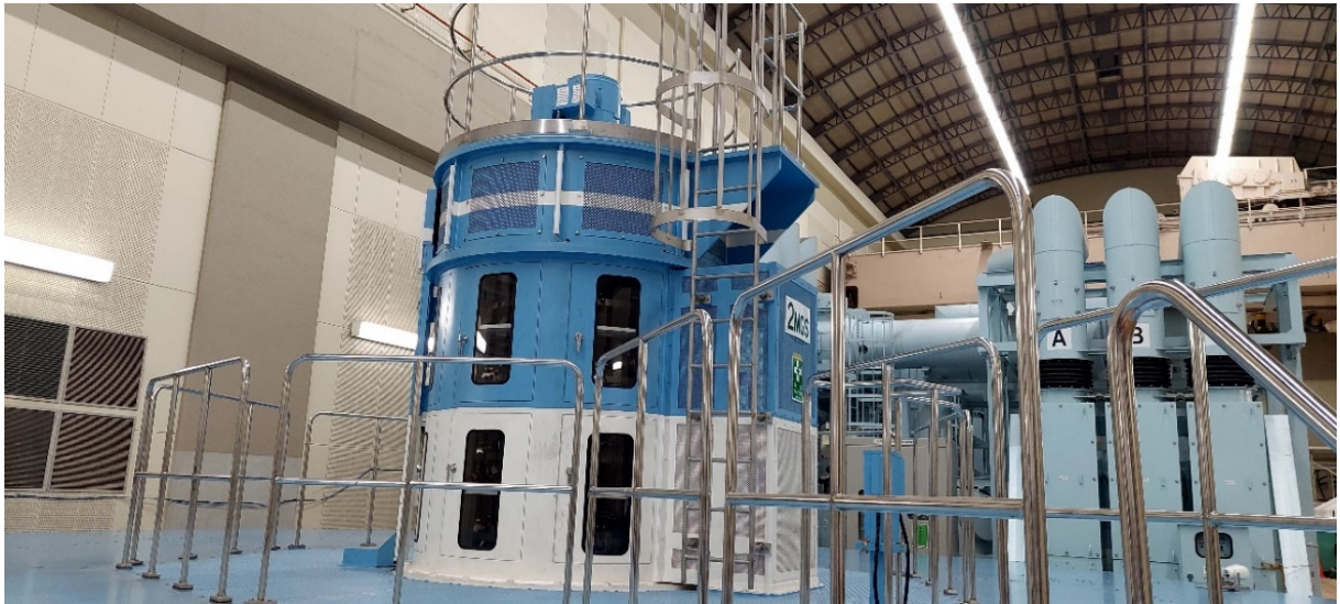
圖 15：一號變頻式發電機組
