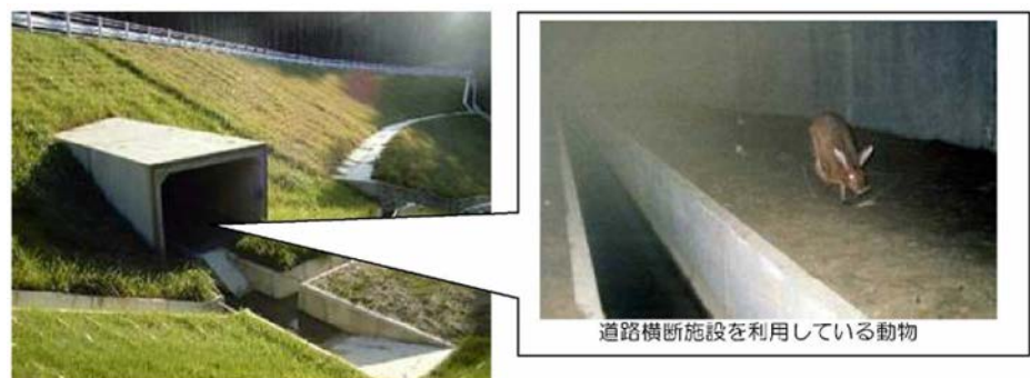
圖 3.1.2-9 穿越馬路的涵洞設施
