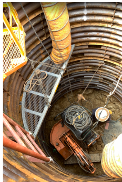
圖 3-40 基坑吊掛防落護蓋
