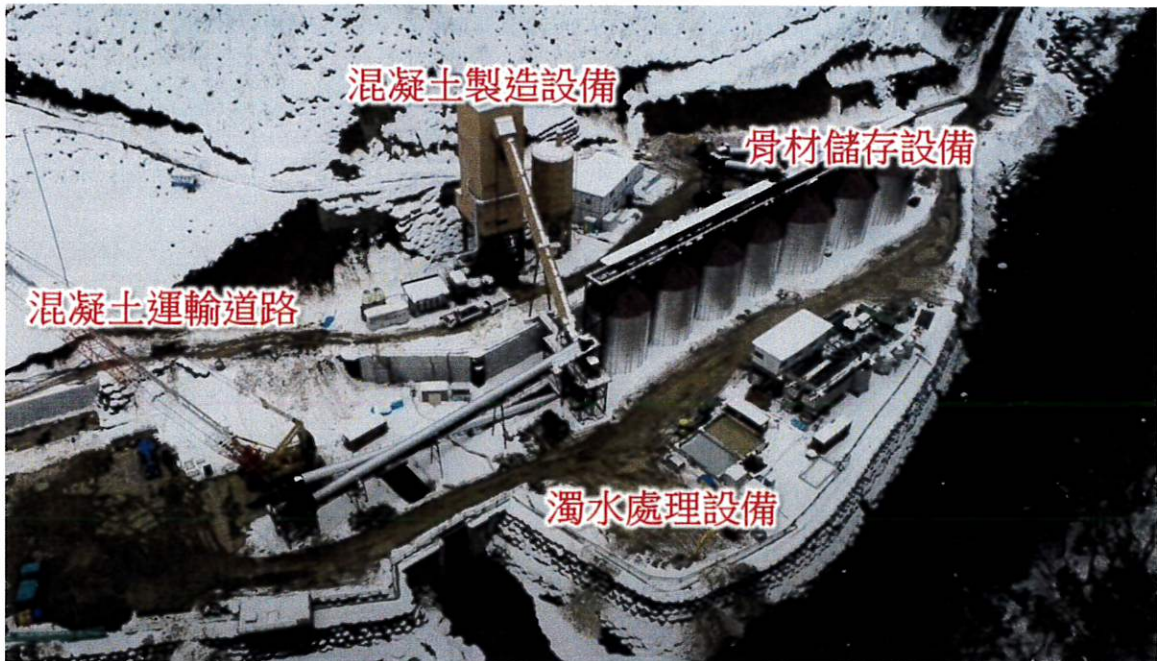
圖 17 骨材儲存設備及混凝土製造等設備 (取自 youtube)
