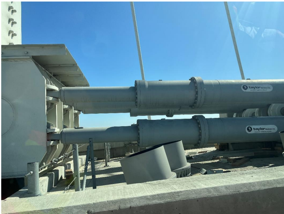
圖十七 橋面 4 個液壓阻尼器
