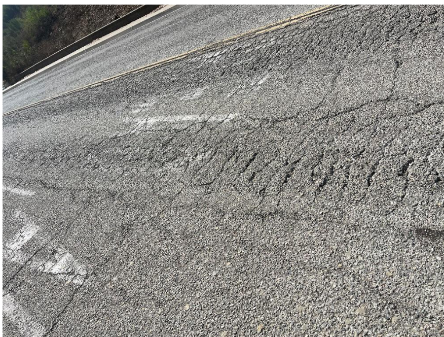
照片一 路面車轍及老化龜裂
