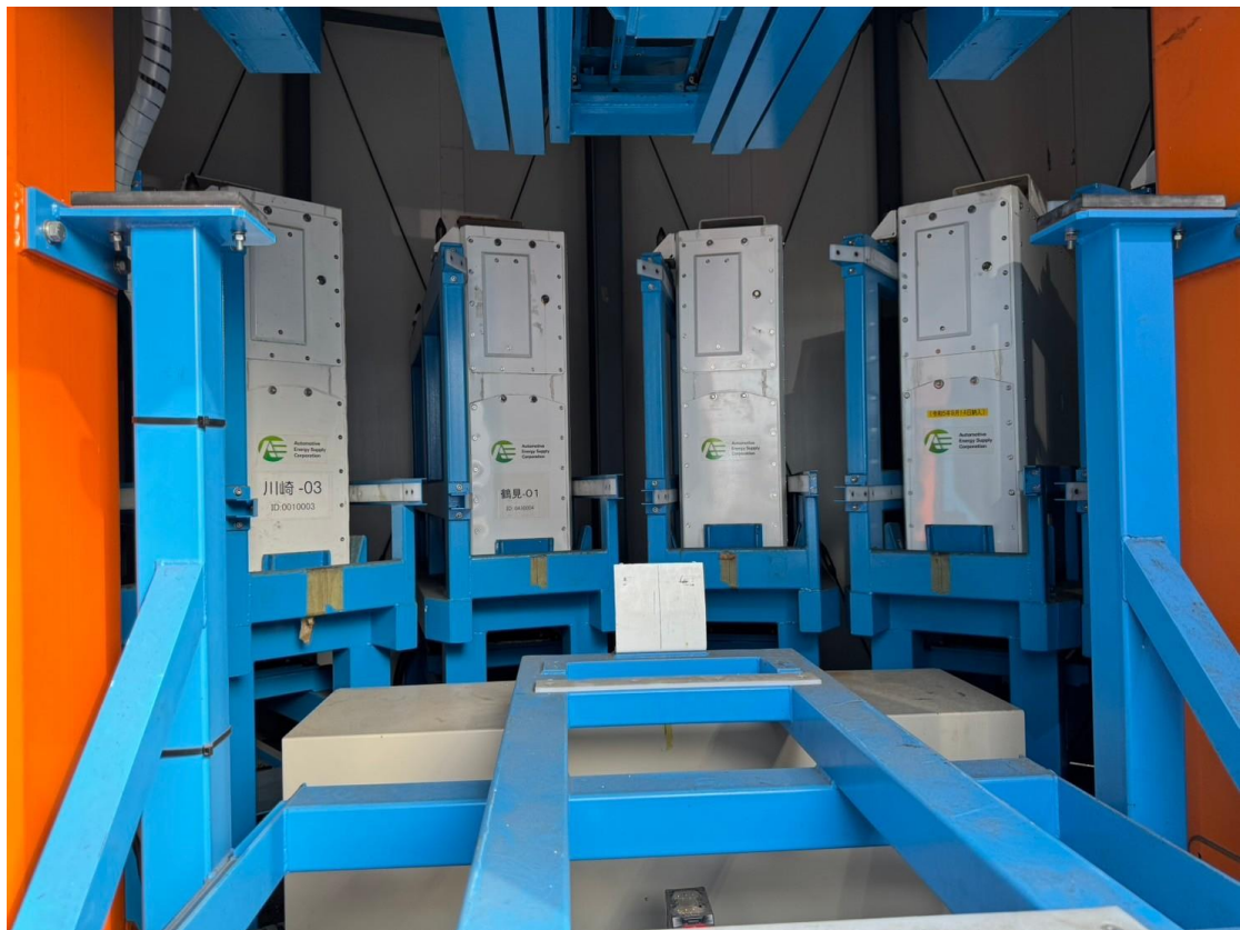
圖 27. JFE 公司 EV ZeroE System 換電站內部
