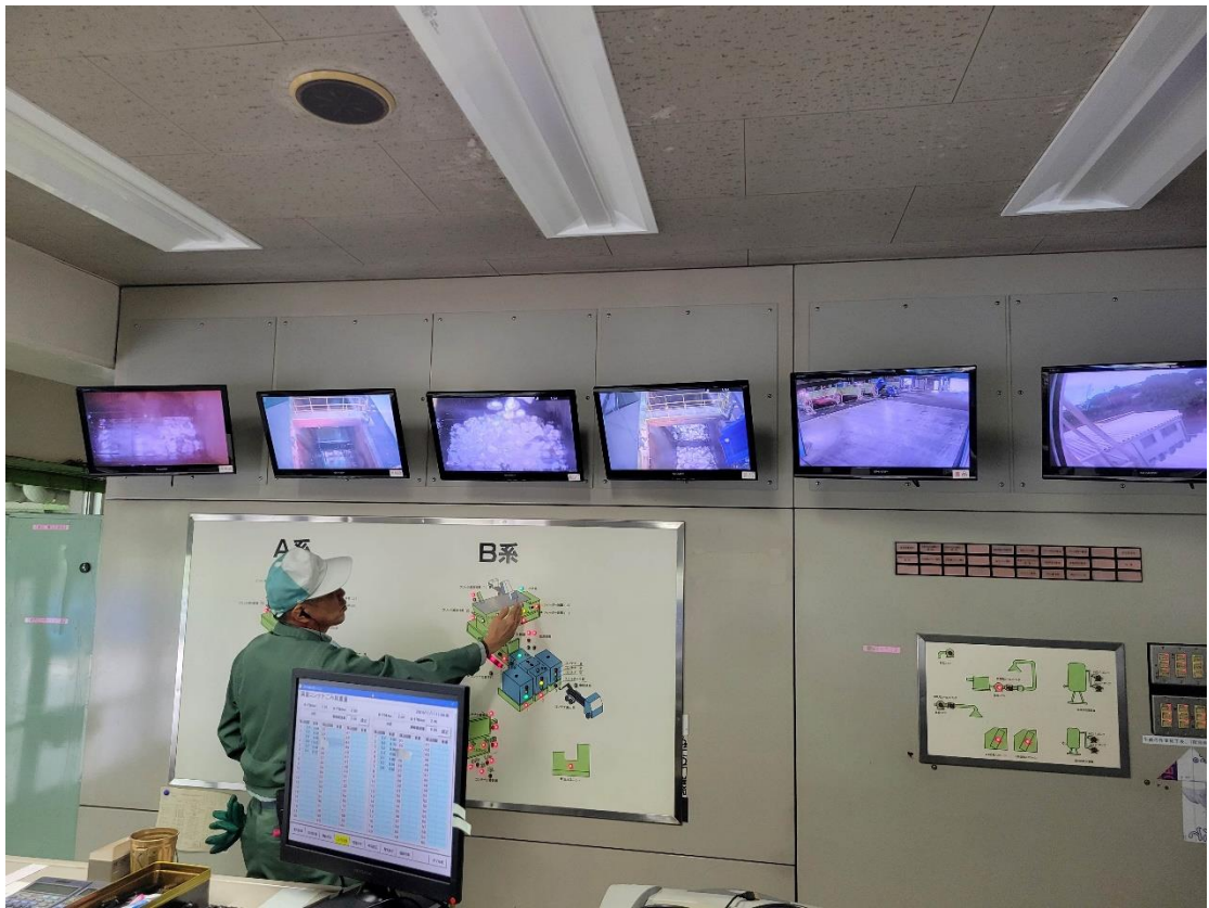
圖 13. 操作室監控設備
