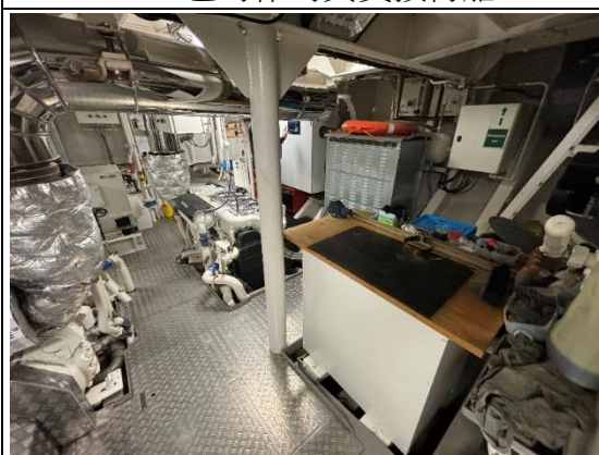
RT BROKUM 機艙內部
