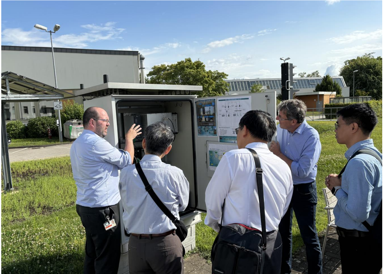
圖 2.1-10 測試軌道旁設備介紹(Smart Wayside Object Controller(SWOC))
