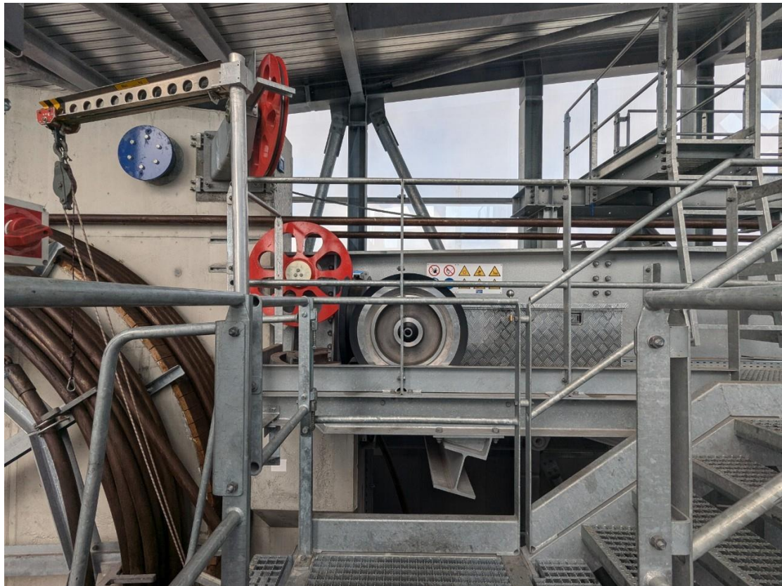
圖 2.3-7 纜車電機驅動系統
