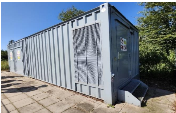
圖 2.2-9 eHighway 道旁變電站外觀
