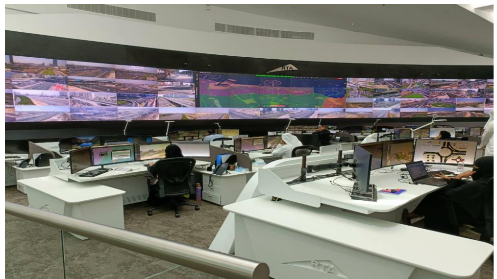
杜拜交通運輸中心內部(值班台)
