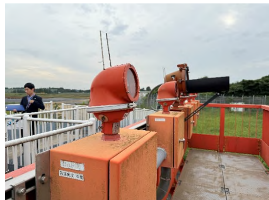
6 度角進場燈與維修控制箱， 可以直接於橋上進行進場燈光設定
