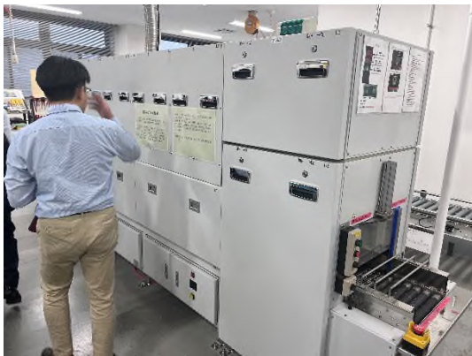
燈具烘乾設備
