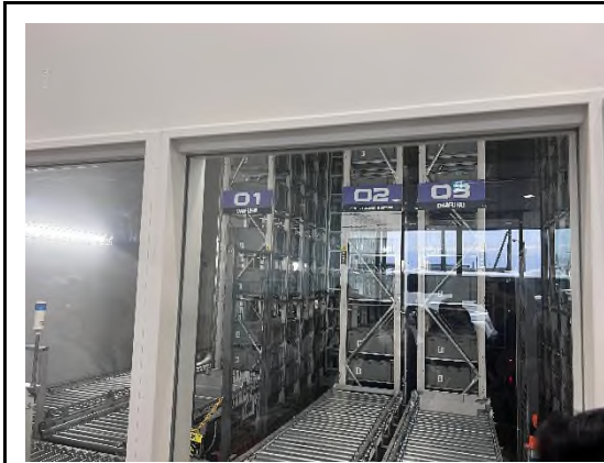
燈具自動化倉儲系統
