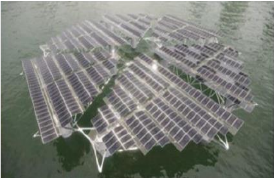
圖 14 浮動太陽光電系統
