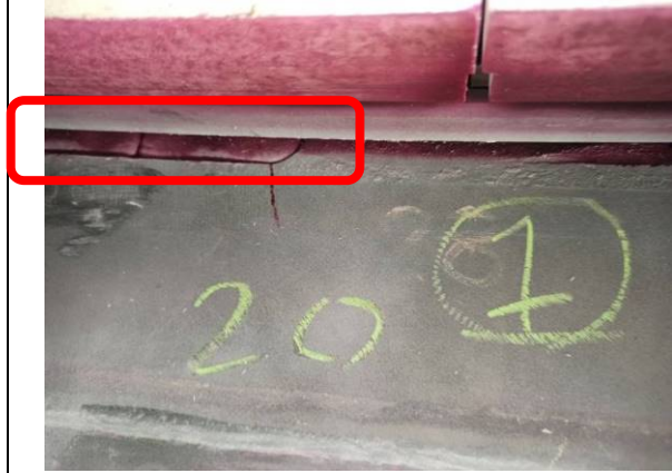
圖二十二、SGT6-2000E型火焰筒與混燒室之間的氣孔擋住情況
