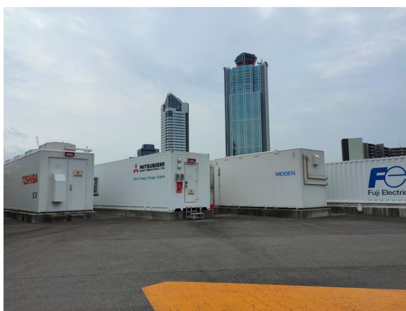
圖 3. 提供測試電力之儲能系統(共計 2 MW)
