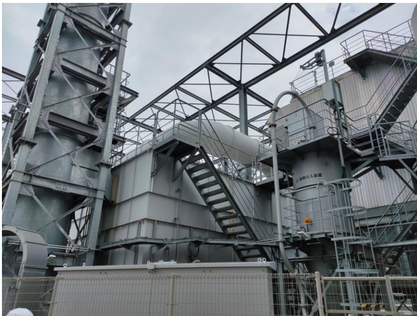
圖 8. 多目的實驗棟廢氣處理設備
