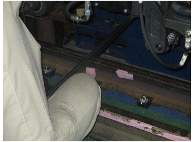
圖 3-3-8 量測車下設備 1
