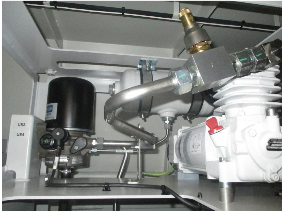
圖 7-5-4 輔助空氣壓縮機與輔助空氣乾燥器
