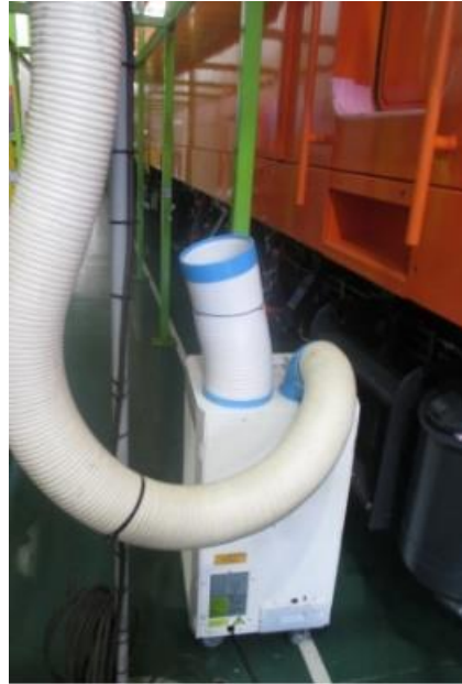
圖 5-1-2 可移動冷氣出風口
