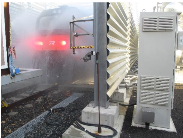
圖 3-8-11 沒有電車線故以電纜供電
