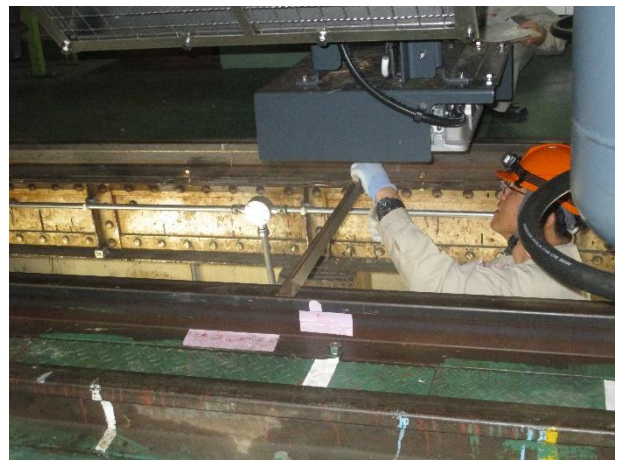
圖 3-3-10 量測車下設備 3
