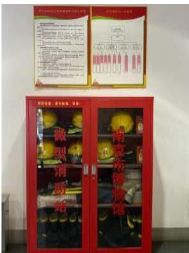
展廳角落的微型消防設備區
