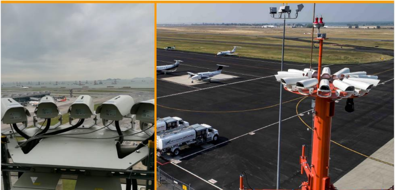
圖 45. 兩種架設攝影機方式：利用現有建物(左)、架設 Mast(右)
