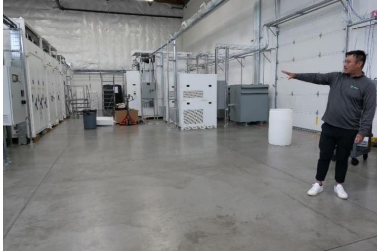
訪團參訪 Powin Energy 工廠能源儲存設備
