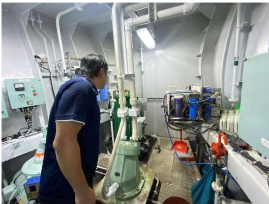
▲查看淨水設備
