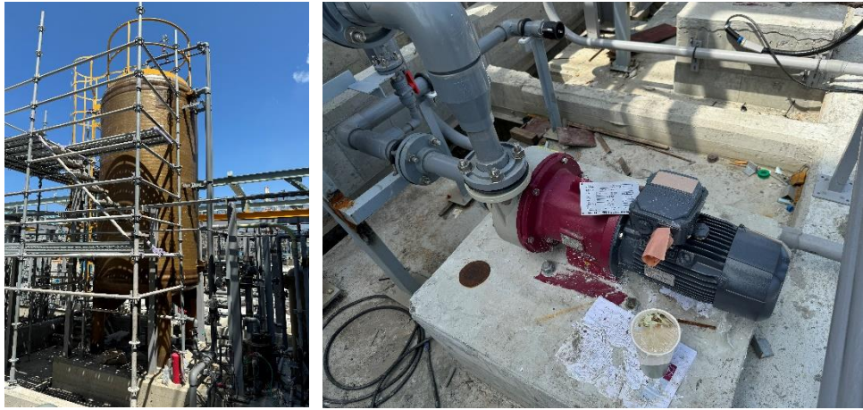
圖 21 32%高濃度鹽酸儲槽(左圖)及 32% HCl 卸藥泵(右圖)
