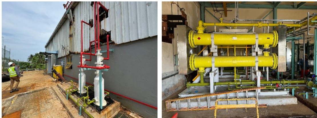
圖 33 西拉雅發電廠海水電解廠房(左圖)及設備(右圖)
