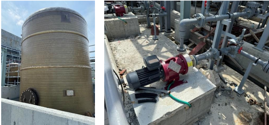
圖 27 12%次氯酸鈉儲槽(左圖)及 12%次氯酸鈉卸藥泵(右圖)
