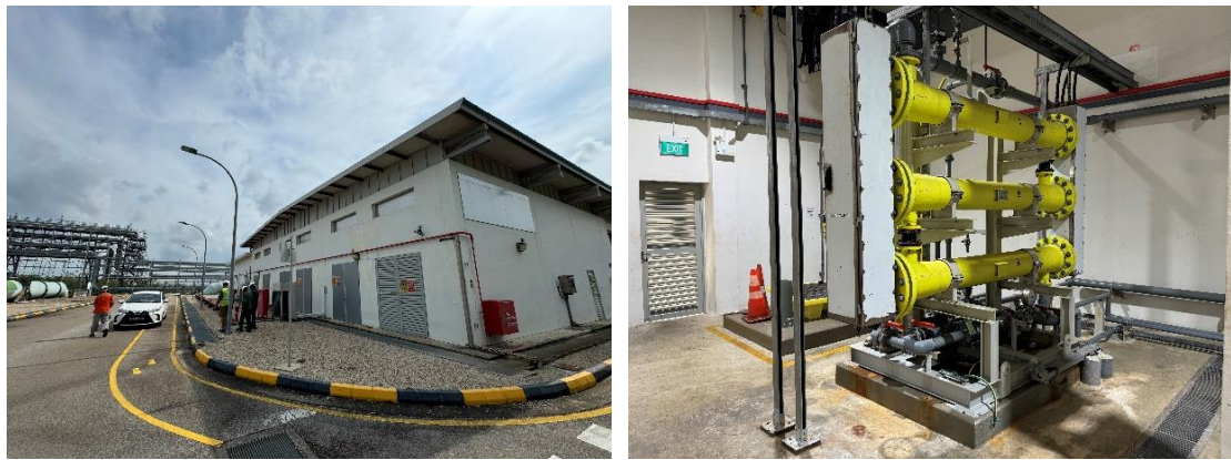
圖 32 勝科公司海水電解廠房(左圖)及設備(右圖)
