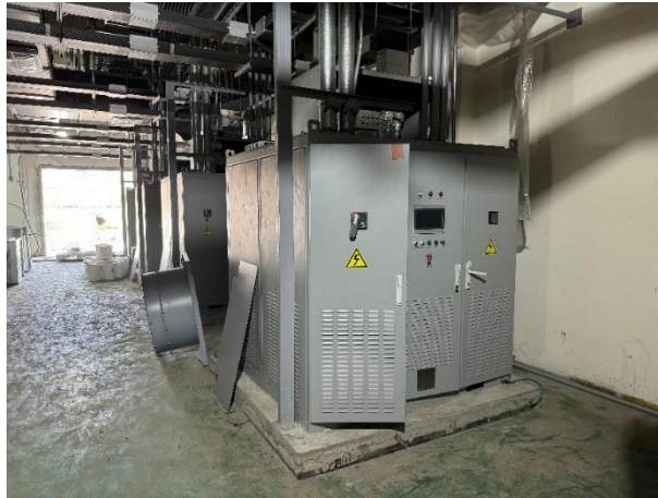
圖 15 變壓器整流器
