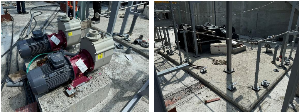
圖 29 處理水泵(左圖)及廢水池(右圖)
