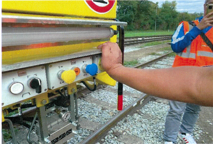
圖 118 軌道穩定車緊急按鈕測試
