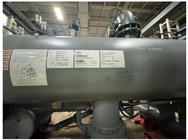
說明：冰機外觀確認
