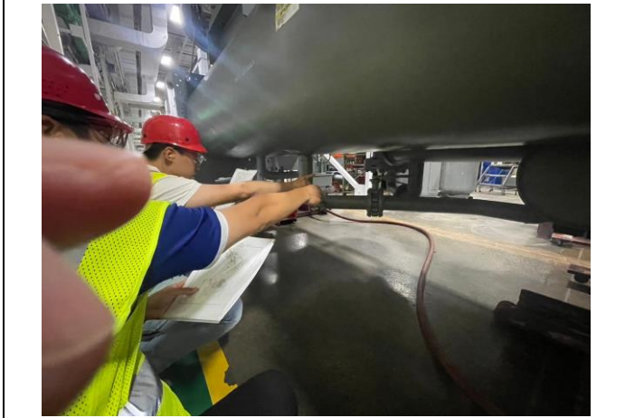
說明：冰機外觀確認
