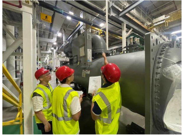
說明：冰機外觀確認
