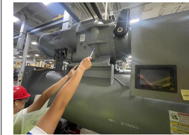
說明：冰機外觀確認
