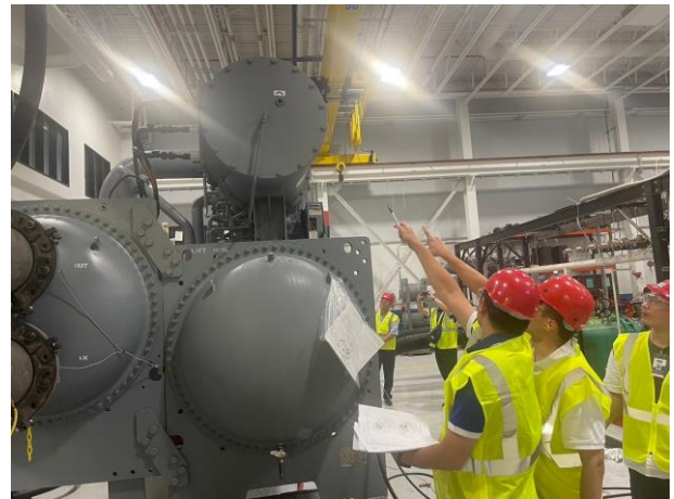
說明：冰機外觀確認
