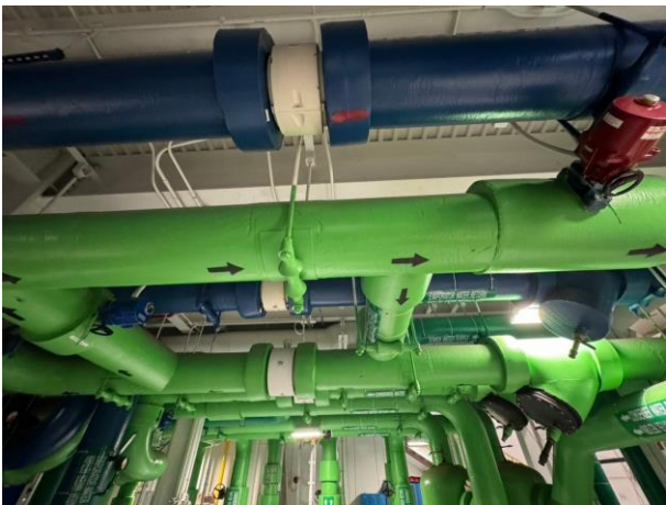
說明：開利廠房測試儀器確認
