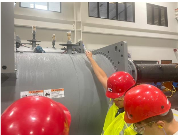
說明：冰機外觀確認
