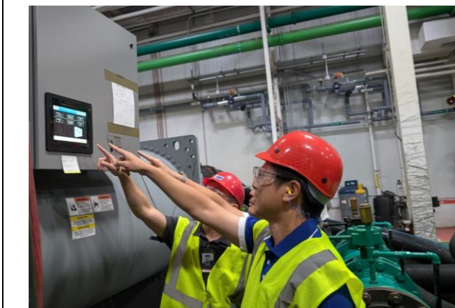
說明：開利廠房測試儀器確認
