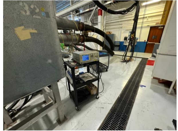
說明：開利廠房測試儀器確認
