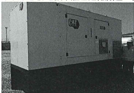
圖 31. 等候連接之緊急發電機。
