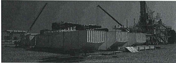
圖 9. 運轉中發電機(共 3 台)。
