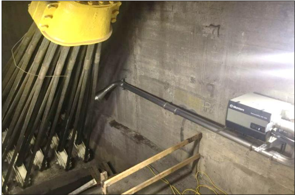
圖 24、錨碇室之除濕裝置
