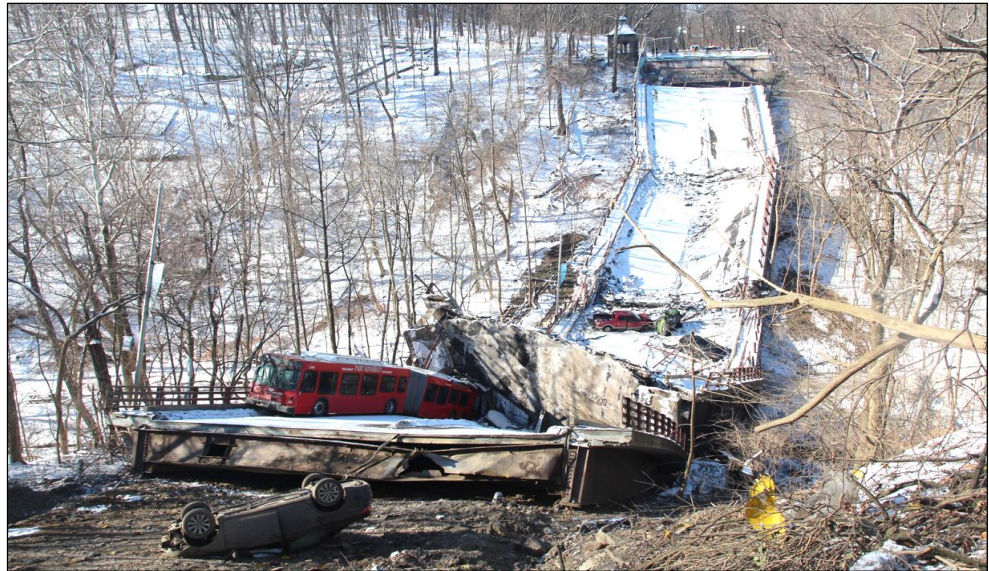
圖 14、Fern Hollow Bridge 倒塌情形
