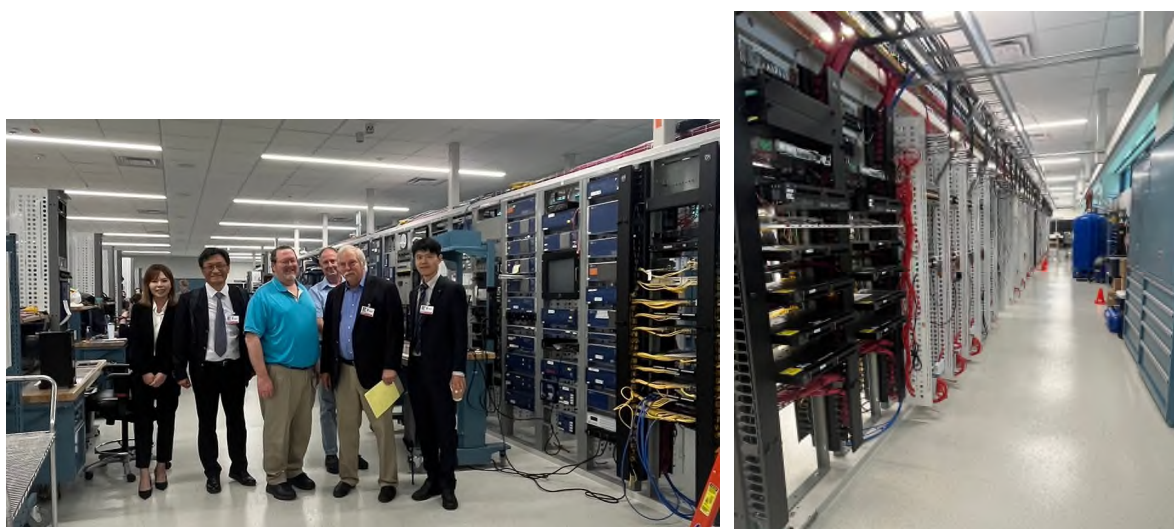
圖 24 保護電驛測試實驗室
