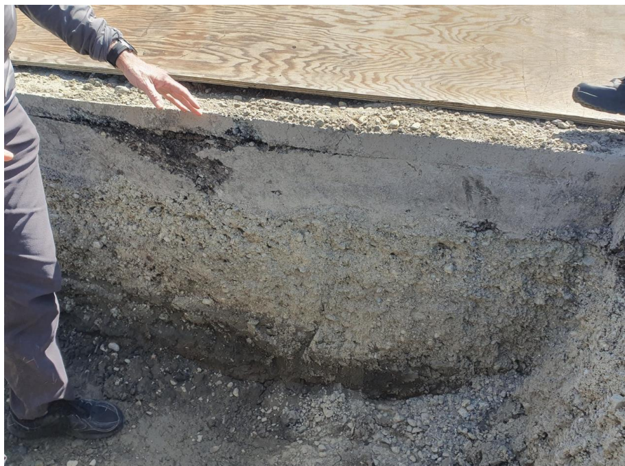
圖 58 測試完成以後可打開斷面檢視深層損壞狀況
