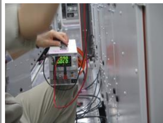
圖 6-5. 利用電源供應器調整輸入電壓
