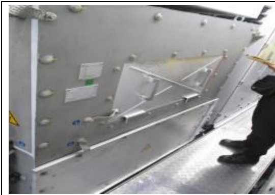
圖 2-7.檢視組合式冷卻塔
