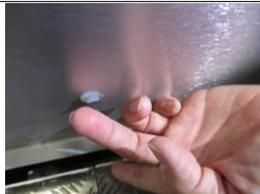
圖 2-8.組合式冷卻塔矽膠填補處滲水
