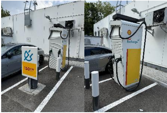
停車格設置 150kw 之 SHELL 汽車充電設施。
