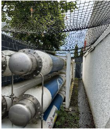
本站氫氣儲存於長管儲氣瓶中。
