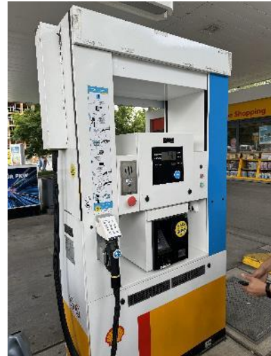
本站加氫機為單槍 700 bar，僅供一般轎車加注。
