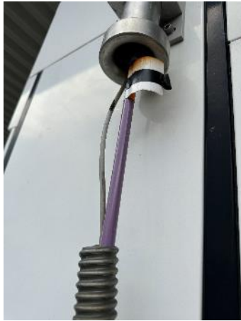
加氫機皮管內共有氫氣管線(紫色)及訊號線(灰色)。
