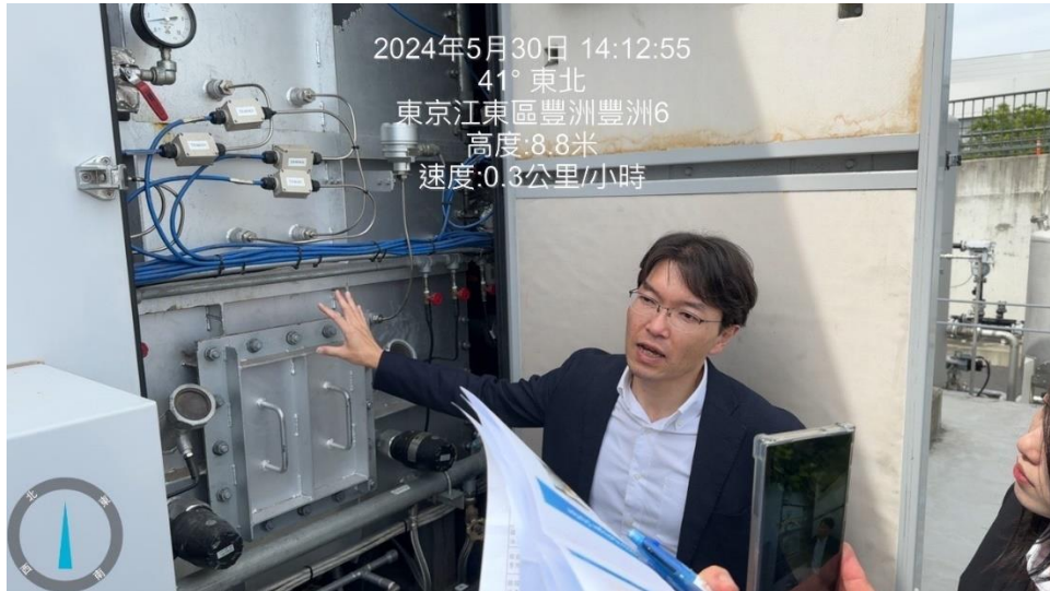
圖 7-4 東京瓦斯豐洲加氫站製氫設備 資料來源：現場相片
