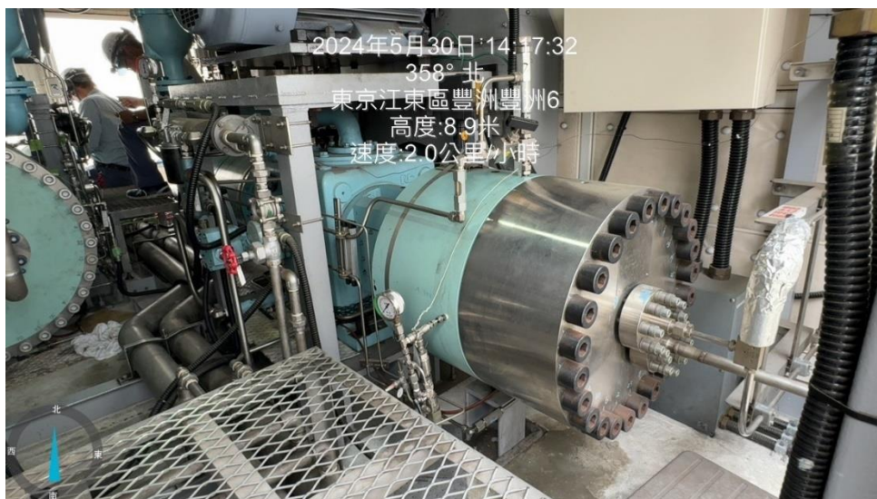
圖 7-5 東京瓦斯豐洲加氫站壓縮機設備 資料來源：現場相片
