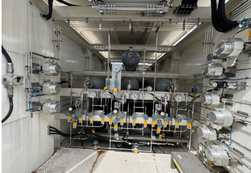
圖 7-6 東京瓦斯豐洲加氫站儲氫設備 資料來源：現場相片
