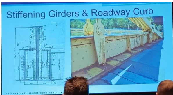
(3) 加勁板及緣石等局部銹蝕嚴重
