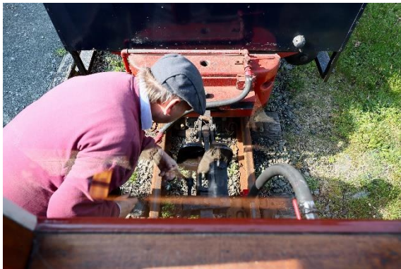
車輛硬體設備檢視
