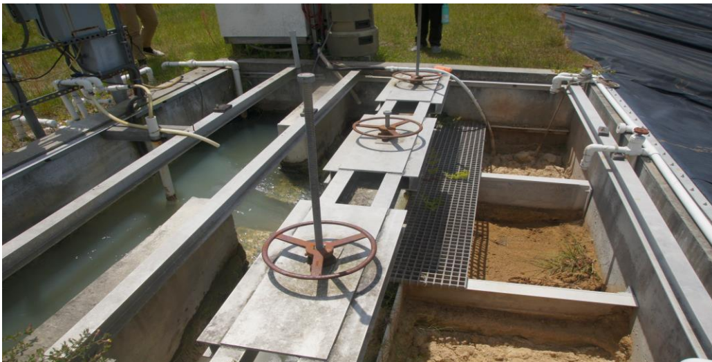
圖 16-1 明礬污水混合池
