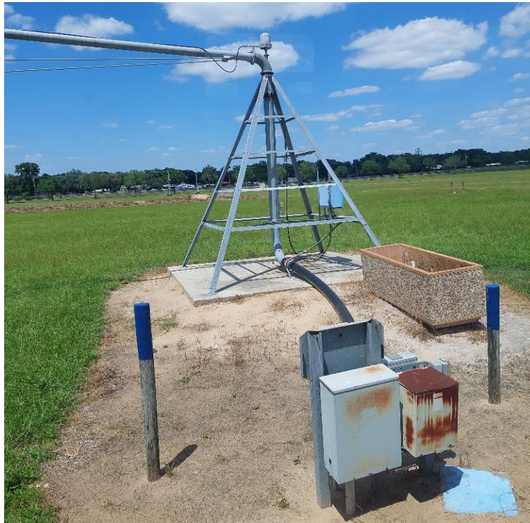
圖 9-2 灌溉設施透過地下管線取水
