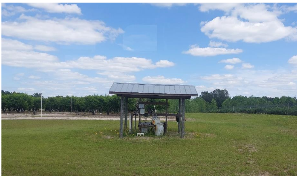
圖 9-1 研究中心所地下水井提供灌溉用水
