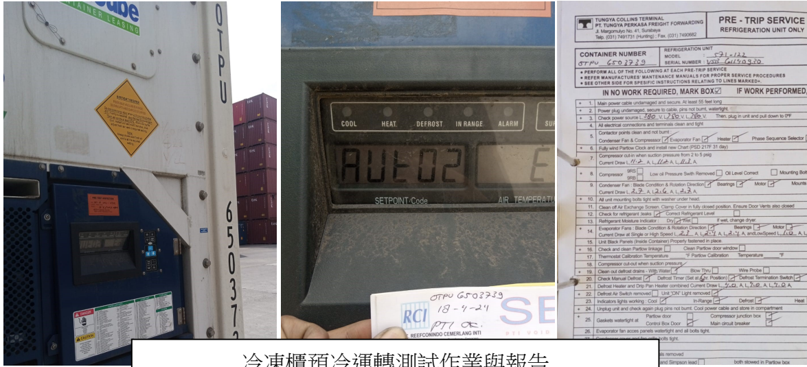
冷凍櫃預冷運轉測試作業與報告
