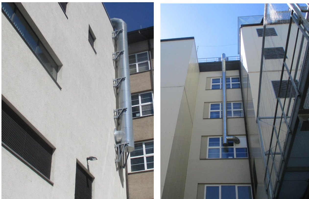
圖 27、輸送至屋頂廢氣管線
