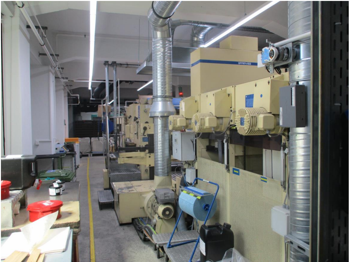
圖 31、密閉圍封搭配電漿處理設備
