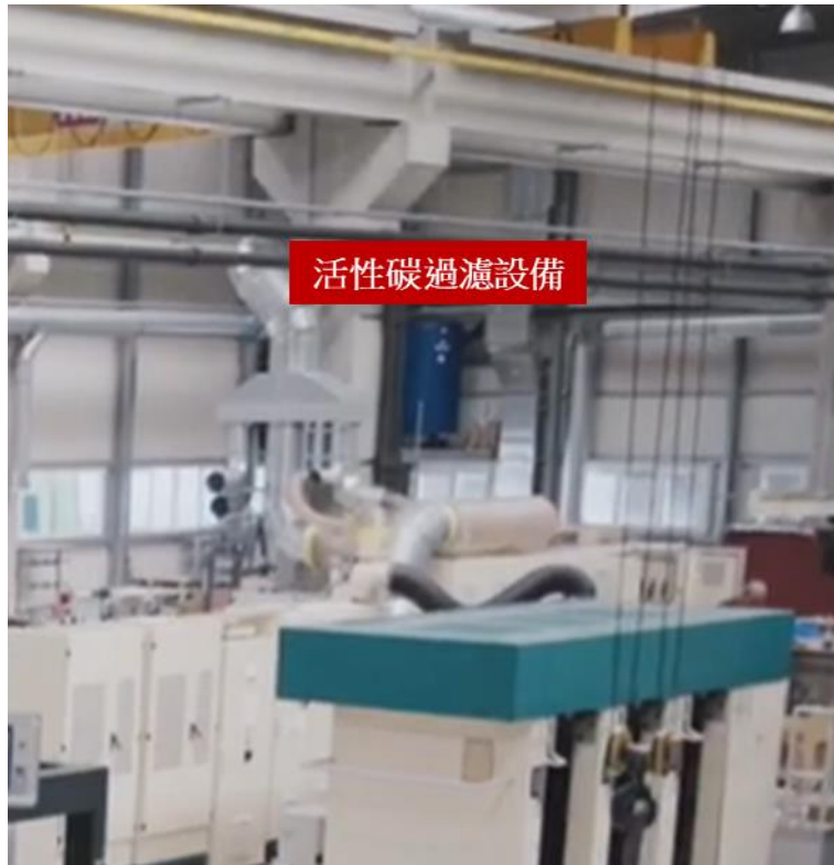
圖 19、設備測試區之活性炭過濾設備
