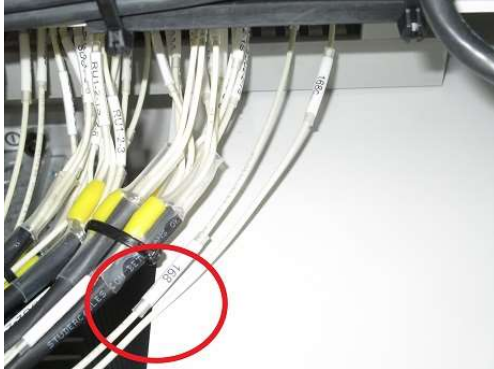
圖5-1-3 ATP 線材未固定易觸碰底板
