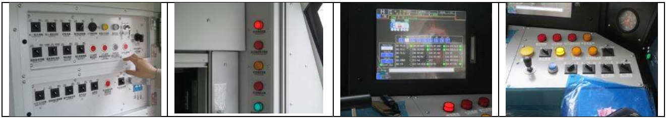
圖3-10-6 E507駕駛室及控制設備功能例行測試(面板盤)
