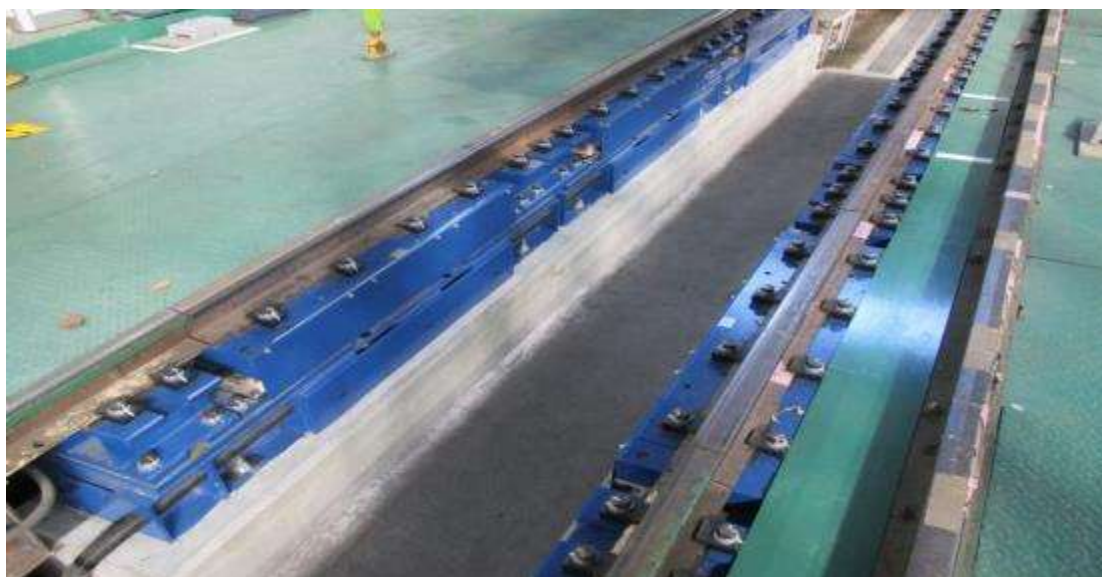
圖 1:軸重量測設備
