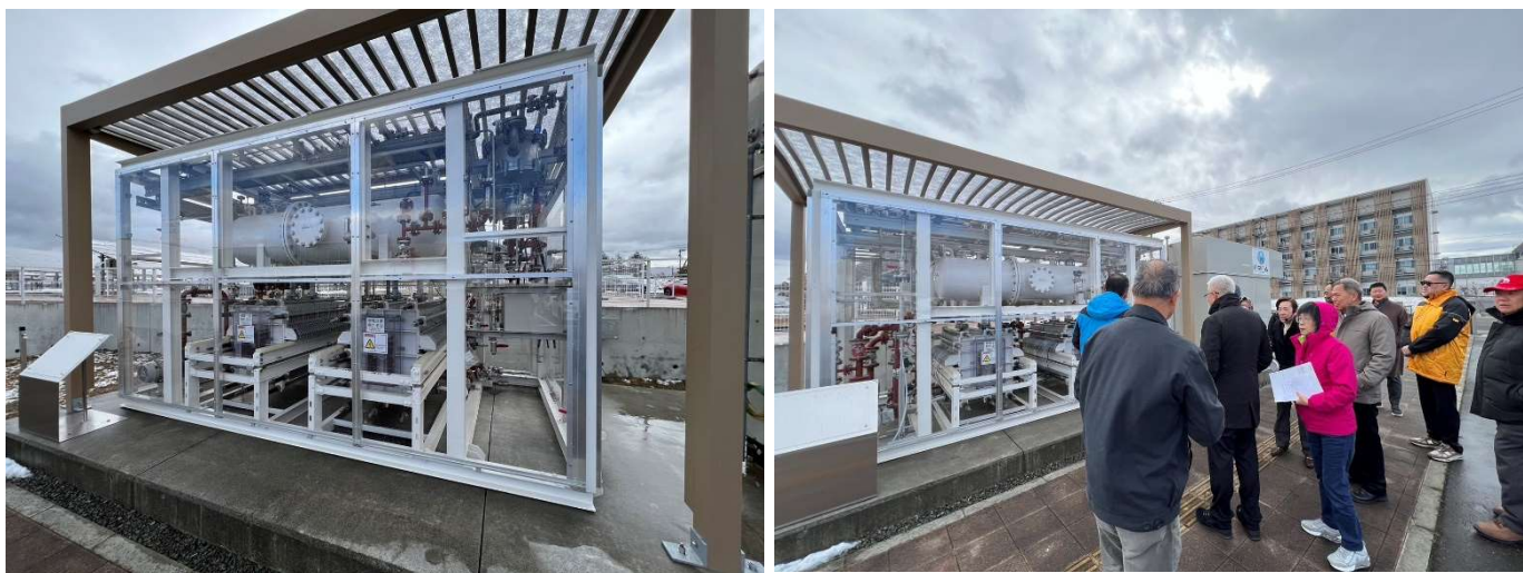
圖 46 AEM 鹼性電解製氫設備
