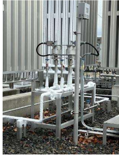
(H)現場輸氫鋼管狀態
