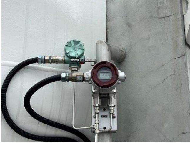
(G) 液態氫槽內部壓力監控
