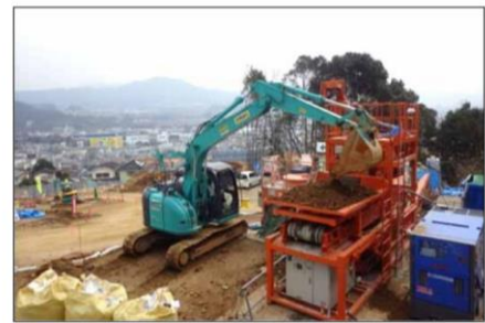
自動測量土石量並自動分配所需的水泥和水。內部材料 (INSEM材料)透過在工廠內計量、供給、混合材料來連續穩定地製造。
