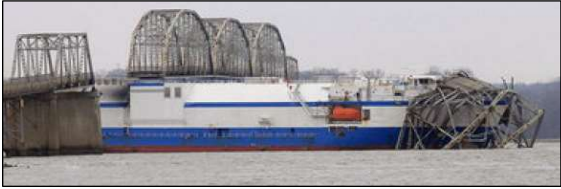
圖3-14 埃格納渡口橋損壞情況 2
